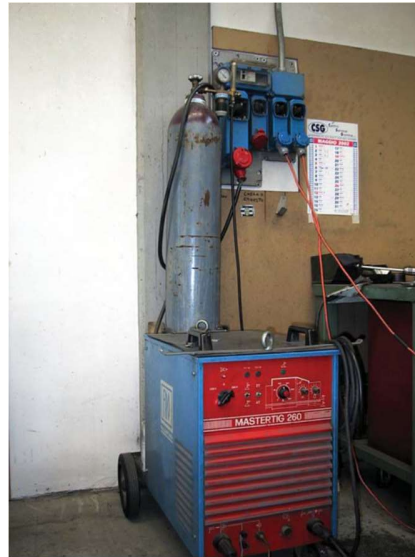
Figura 17 – Generatore e bombola di gas inerte
